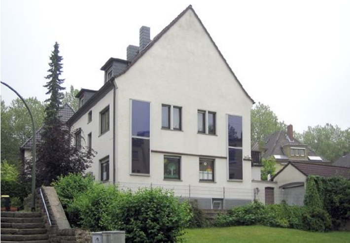
Thermische Solaranlage in Fassadenmontage Kollektorfläche 10,8 m 2 Recklinghausen, 2003
