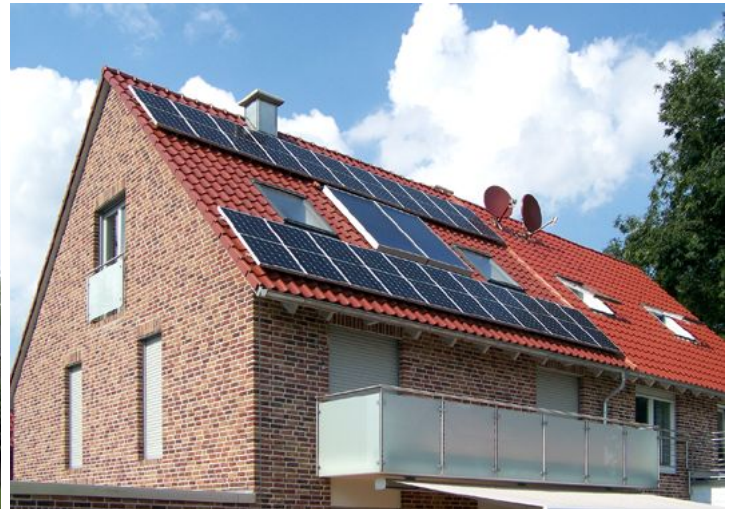
Thermische Solaranlage und Photovoltaikanlage Kollektorfläche 5,2 m 2 , Modulleistung 4,07 kWp Herne, 2006
