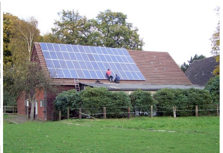
Photovoltaikanlage, Modulleistung 10,2 kWp Castrop-Rauxel, 2008
