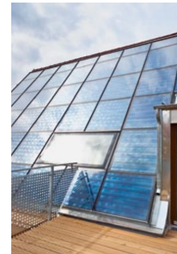
Abb. 31: Dachansicht mit Solarfeld
