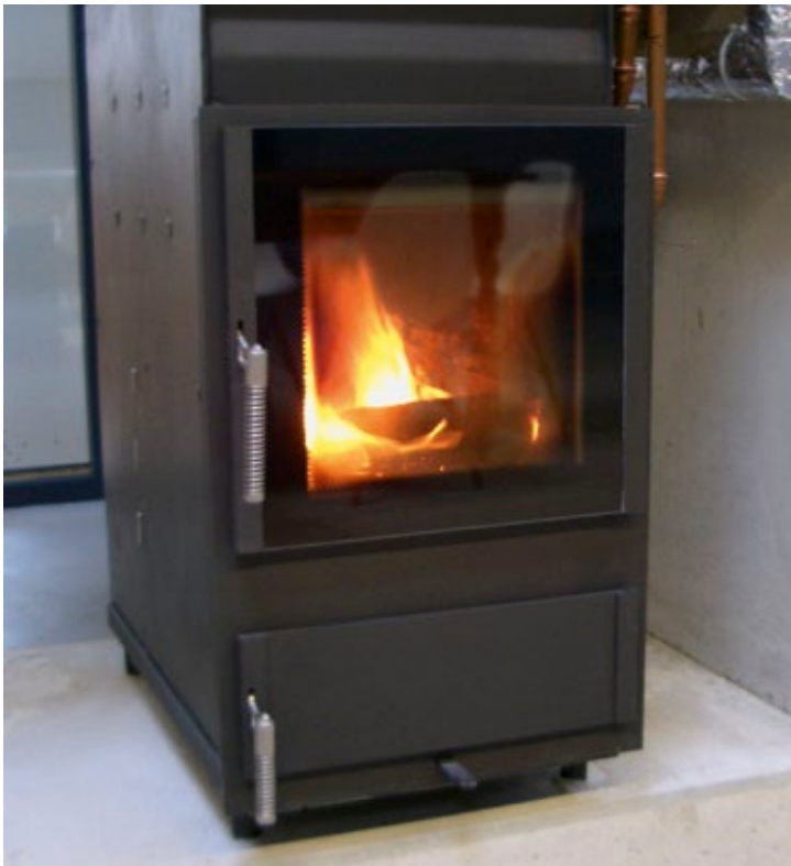
Abb. 41: Kaminofen zur Restwärmeabdeckung
